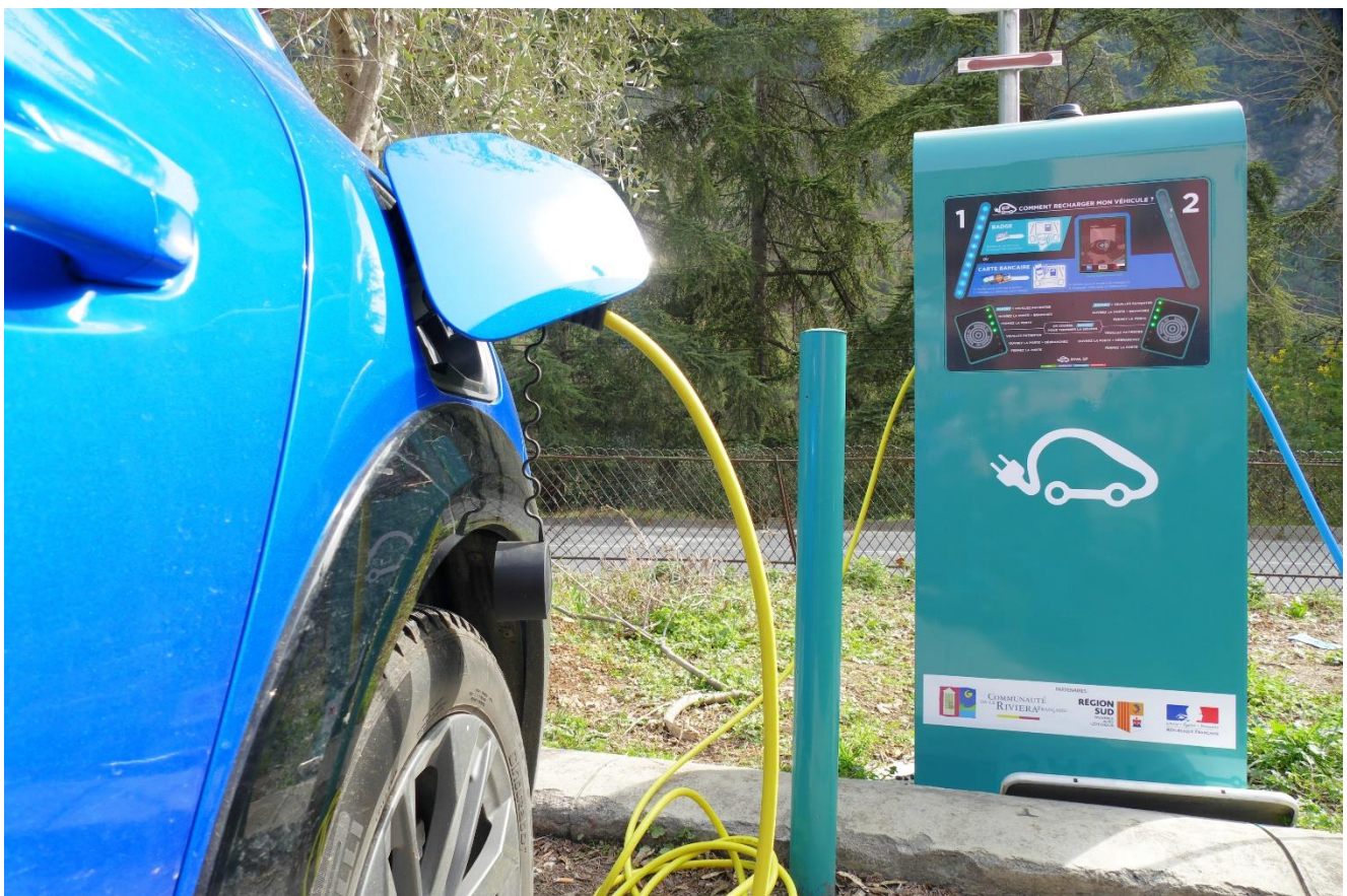
Borne de recharge pour les véhicules électriques
