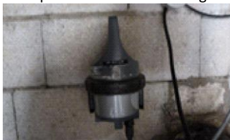
Poste local de sectorisation
