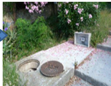
Compteur à l'extérieur du regard
