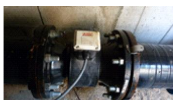
Débitmètre sur canalisation
