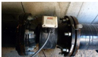
Débitmètre sur canalisation
