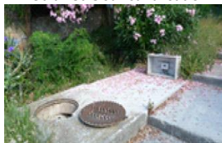
Compteur à l'extérieur du regard
