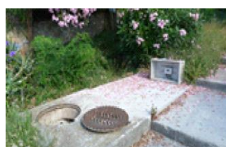
Compteur à l'extérieur du regard
